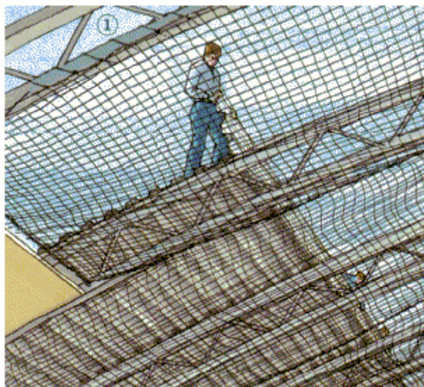
Slika 4: Varovalna (lovilna) mreža za lovljenje orodja, predmetov in ljudi pri izvajanju del z montažno gradnjo. (18)
